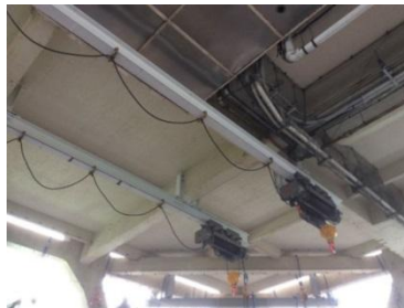
写真 4. 天井クレーン
