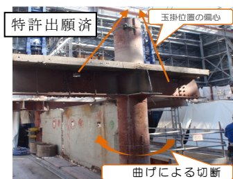
写真12 偏心荷重による柱曲げ切断
