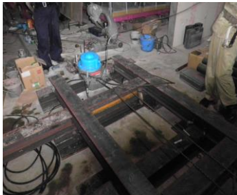
チルクライマー設置
