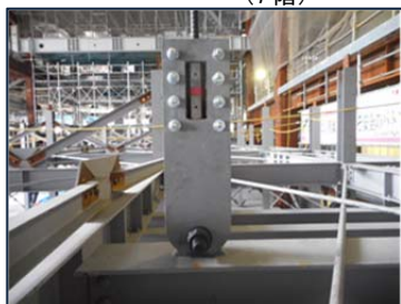
下部接続状況
