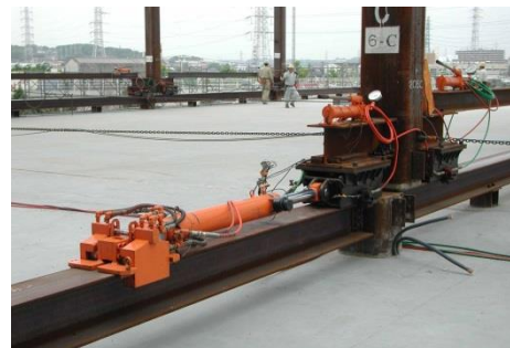
トラベリング装置設置状況
