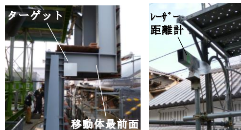
写真-3 素屋根移動量計測器
