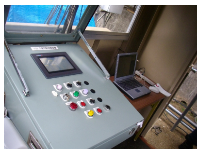
写真-14 メイン操作盤
