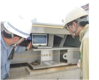
支承部にて制御表示確認
