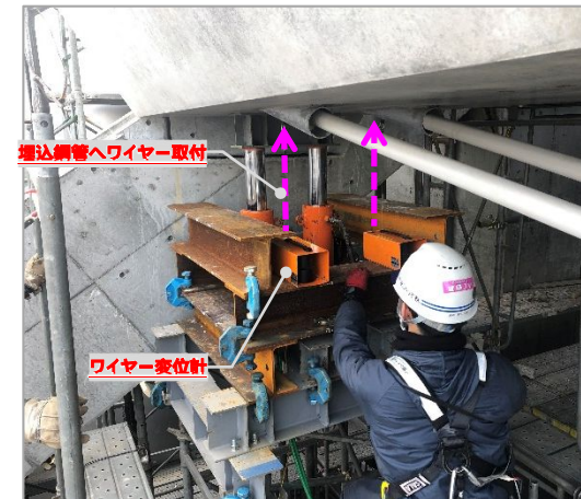
ワイヤー変位計設置状況
